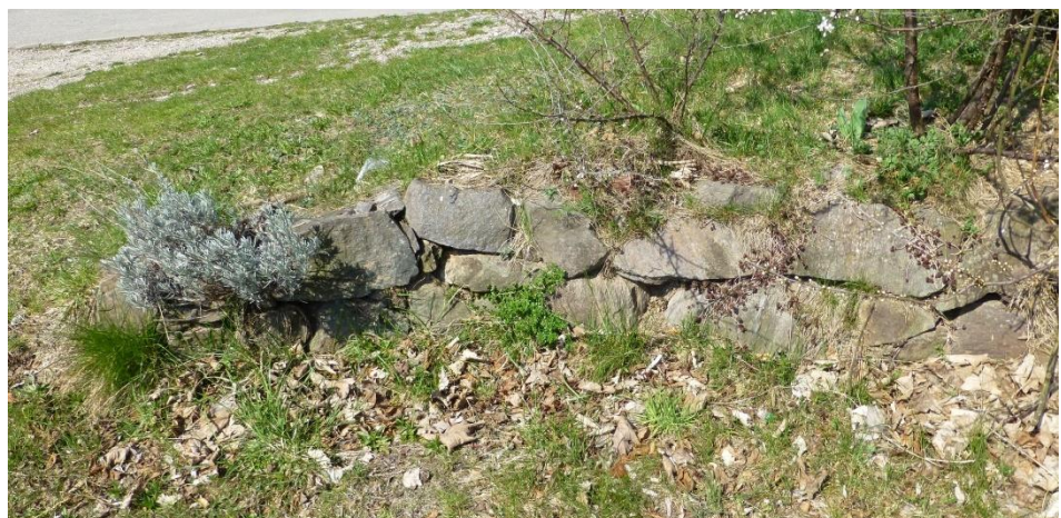
Abb. 5: Unverfugte Mauer südlich des Betriebs- und Wohngebäudes
